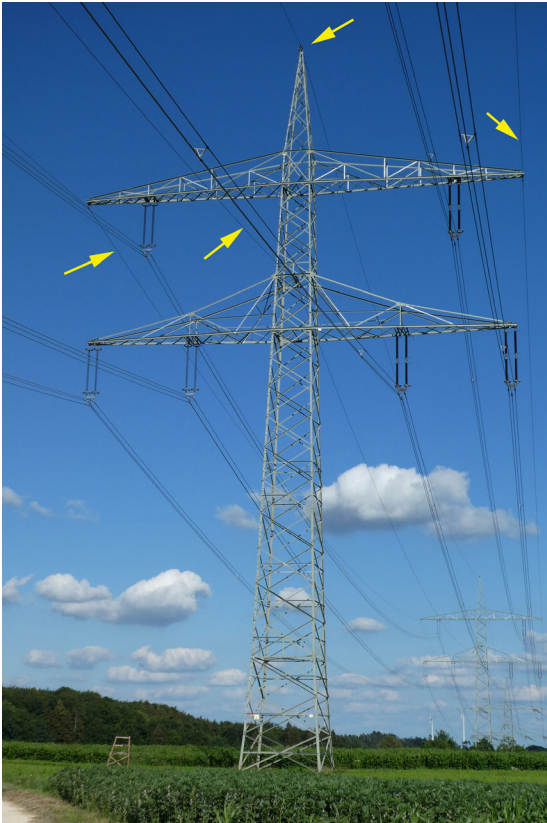
Abb. 5: Mast der 380 kV-Leitung mit Donau-geometrie und vier Erdseilen (Pfeile)
